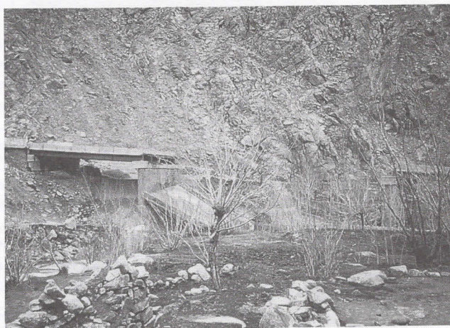
Sur le flanc nord du col du Salang, la destruction de ce pont, par les troupes de Massoud en septembre 1996, rend l'axe nord-sud inutilisable, avril 1997. Photo D.R.
